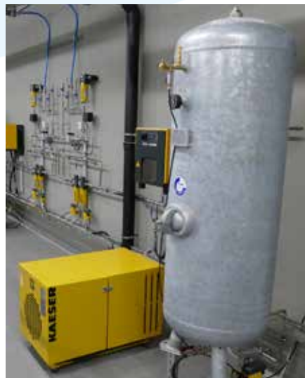
Kompressor bzw. Steuerluftanlage
