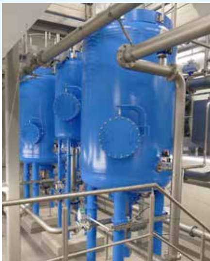
Oxidator und Enteisenungsfilter
