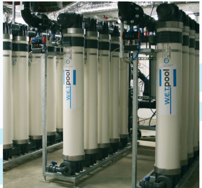
Ultrafiltration für die Kreislaufaufbereitung
