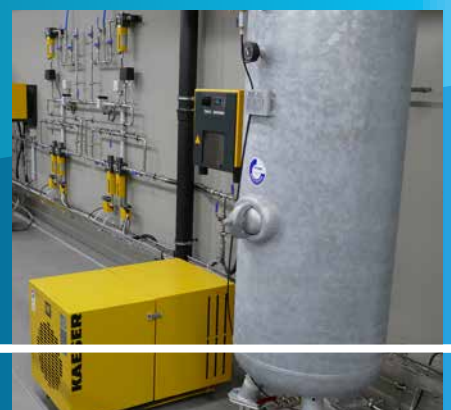
Kompressor bzw. Steuerluftanlage
