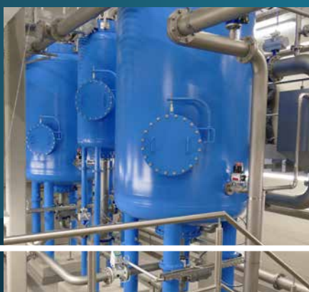
Oxidator und Enteisungsfilter
